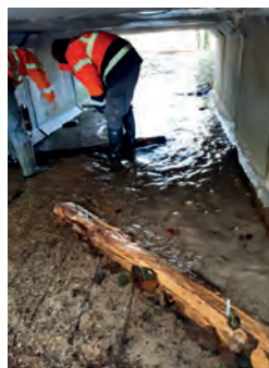
Pour favoriser la circulation des espèces piscicoles, le radier d'un pont a été équipé de rondins pour réduire la largeur d'écoulement en période de basses eaux.
