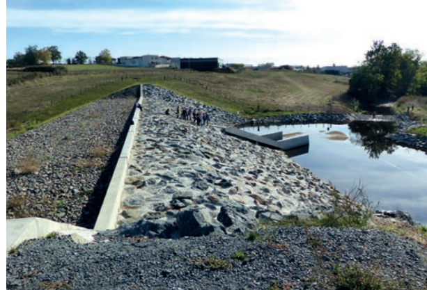
De nombreuses visites auprès des syndicats de rivière voisins de la Loire et du Rhône ont permis aux élus du SMAGGA d'appréhender la présence d'un ouvrage écrêteur de crues dans le paysage.
