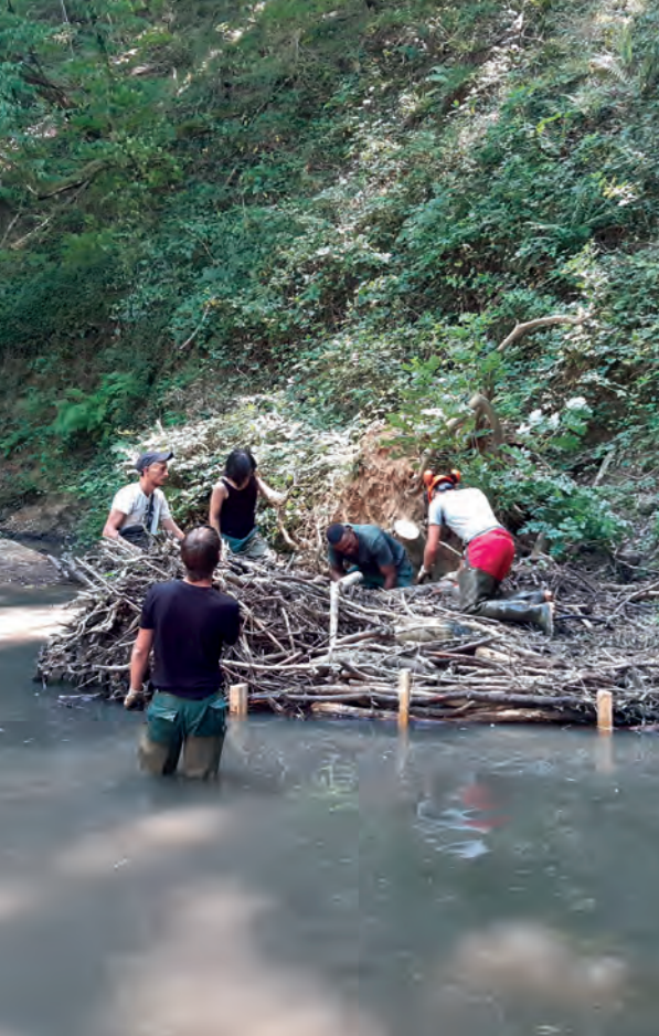
Sur le Garon, la Brigade Nature œuvre à la réalisation d'un peigne pour le renforcement d'une berge.
